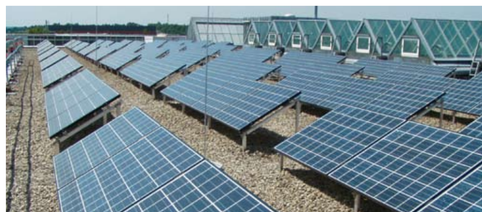
Solkollektoren auf dem Dach des UKR
