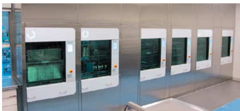
Die neue ZSVA 1. Sechs neue Durchlade-Waschanlagen. Mit der Prozessstatusanzeige (Sonne) – zur Darstellung von Restlaufzeit, Be- und Entladebereitschaft oder Störungsmeldungen – auch aus 20-Meter-Distanz gut sichtbar.
